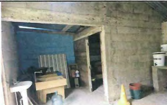
Foto 3: Cernido de paredes de interior de cocina y bodega
